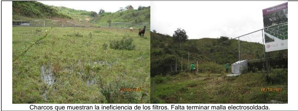
Charcos que muestran la ineficiencia de los filtros. Falta terminar malla electrosoldada.
