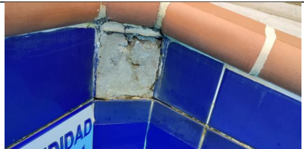
Ausencia de enchape en piscina.
