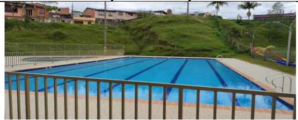
Piscina Municipal de Guatapé – ausencia de cerramiento hacia Zona Verde.
