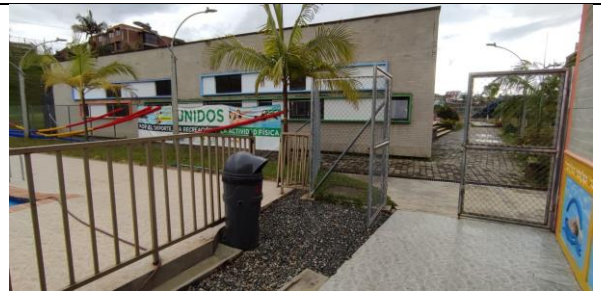
Acceso a piscina – cerramiento no funcional.
