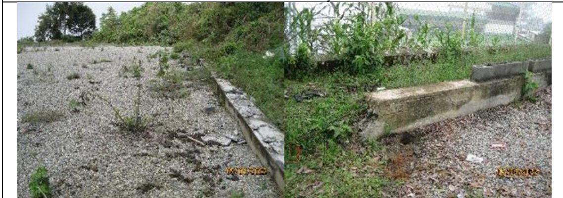
Viga de cimentación sin terminar e hilada de bloque dañada en varias partes.
